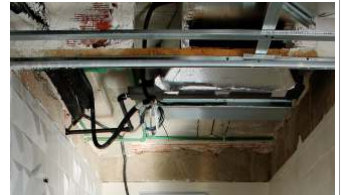
Detalle de las instalaciones
